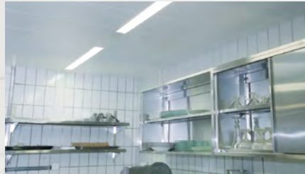
Zuluftdecke als Überdruckdecke
